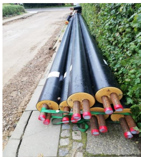
写真1. 暖房用パイプ（筆者提供）
