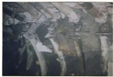
支保工の変状 SL付近
